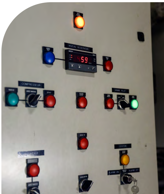
Armoire électrique d'un réservoir
